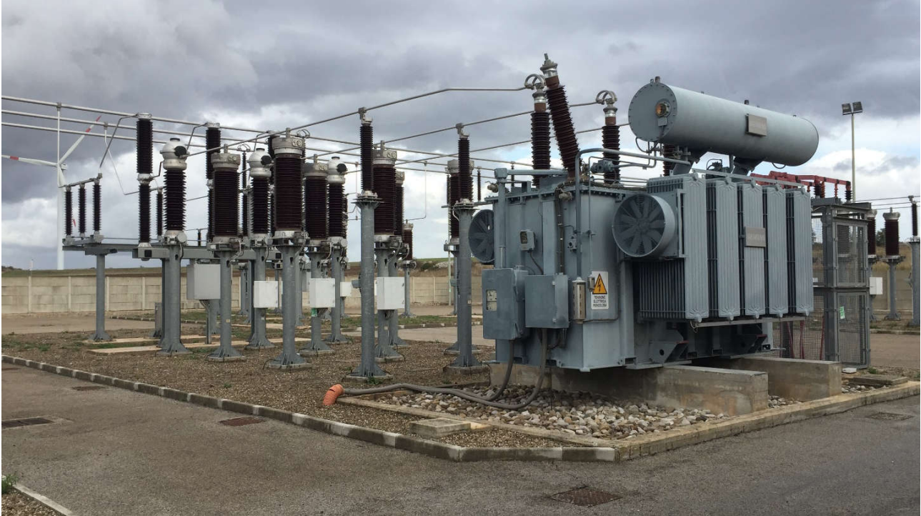
Figura 13 - Sottostazione del parco eolico
